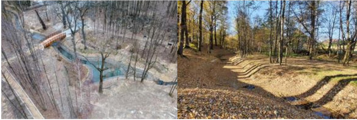
Rys. 6.78 Przykład przebudowy kanalizacji deszczowej na otwarty system zbiorników retencyjnych – park miejski w Czechowicach-Dziedzicach (Fot. M.Janik)
